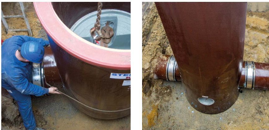
Asentamiento del pozo
