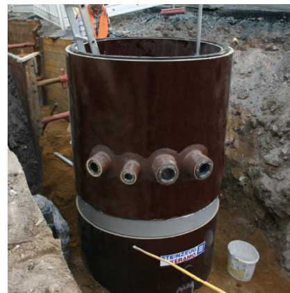
Regard spécial DN 1200 avec raccords pour conduites sous pression dans la rehausse
