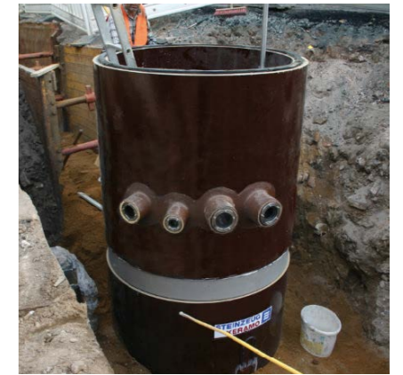
Regard spécial DN 1200 avec raccords pour conduites sous pression dans la rehausse
